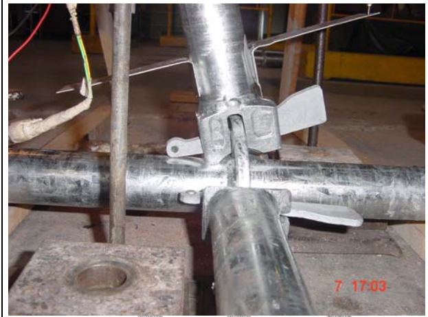
Fotografía 32: Detalle de la falla por giro que presenta la conexión del sistema Pie Derecho - Travesaño.
