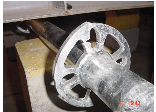
Fotografía 36: Rotura de la perforación en disco de empotramiento.
