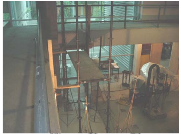
Fotografía 2: Vista de superficie de trabajo formada por plataforma abatible.
