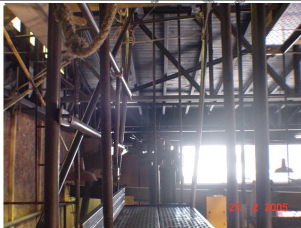
Fotografía 35: Detalle del pandeo global que se produce durante el ensayo de carga vertical a 3 cuerpos.
