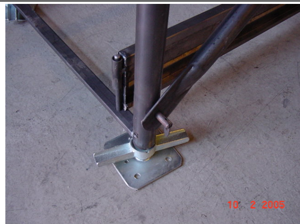
Fotografía 6: Detalle típico del apoyo de los andamios.
